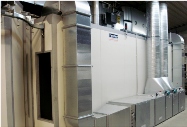
Abb. 6 Kühlzone mit Frischluftbetrieb, Aggregate seitlich angeordnet
