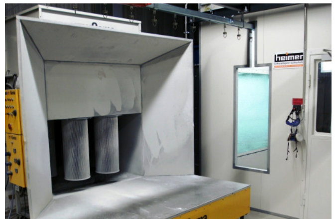
Abb. 2 Positionierung der beiden Beschichtungsstände. Die Nutzung erfolgt im Entweder-oder-Betrieb
