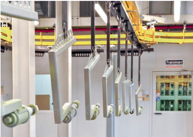
Vor der Lackierkabine läuft eine handgeführte Staustrecke entlang.
