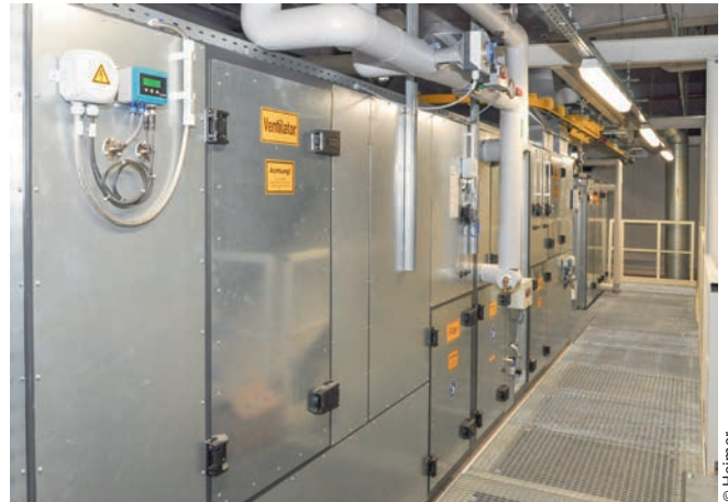
Die hohe Wärmerückgewinnungsrate der Zuluft- und Abluftgerätektechnik auf der zweiten Anlagenebene reduzieren den Energieeinsatz im Lackierbereich deutlich.
