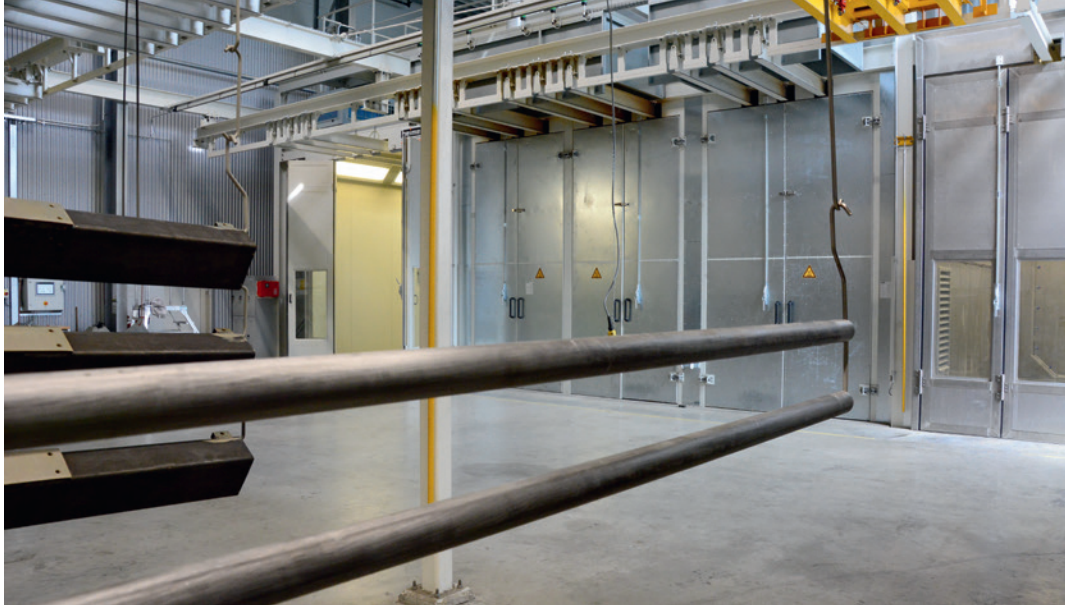
Das Teilespektrum reicht vom Kleinteil bis hin zu 1600 kg schweren Maschinenkörpern. Im Hintergrund (v.l.n.r.): Pulverkabine, Einbrennofen, Haftwassertrockner und Reinigungs- /Vorbehandlungskabine.
